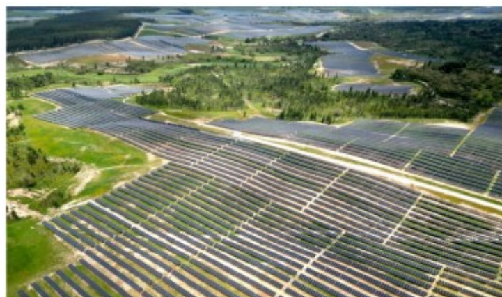
Parque solar na herdade da Torre Bela, Azambuja (Valor Local, 2025)
